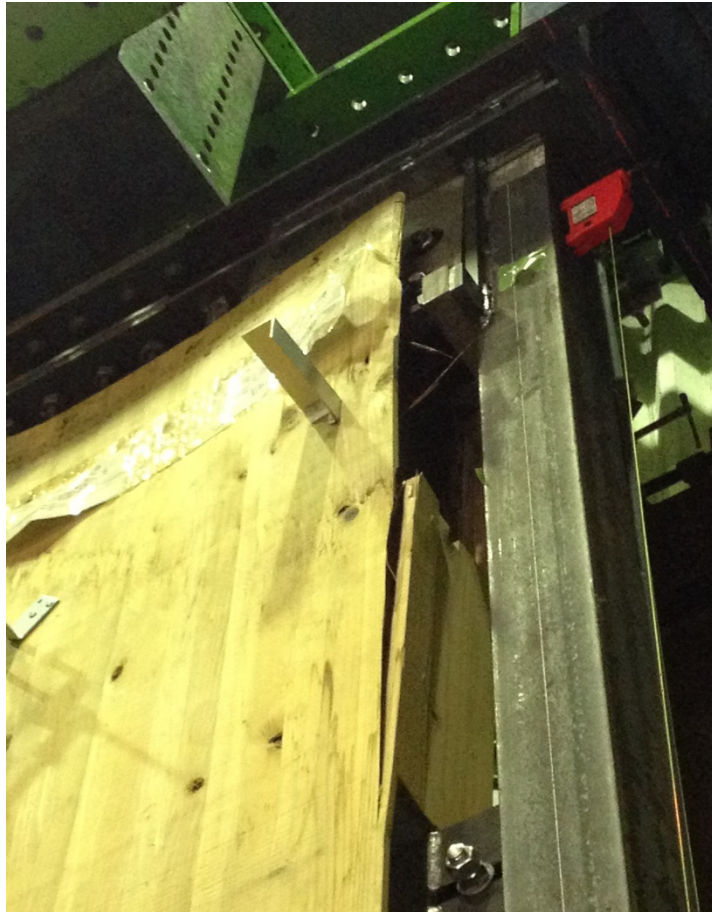
a) 木質パネル頂部のめり込み破壊状況
