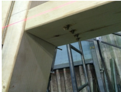
b) ブロッキング材の接合部ネジの抜けだし
