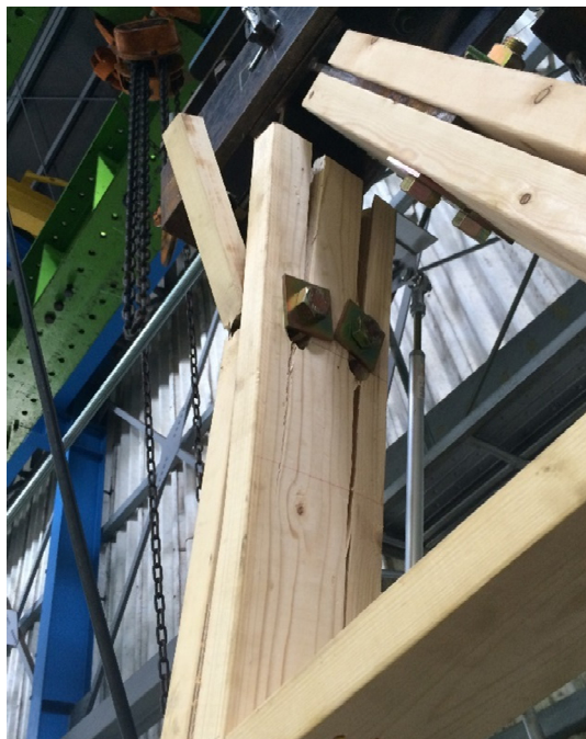
b) 柱頭部の割裂破壊状況
