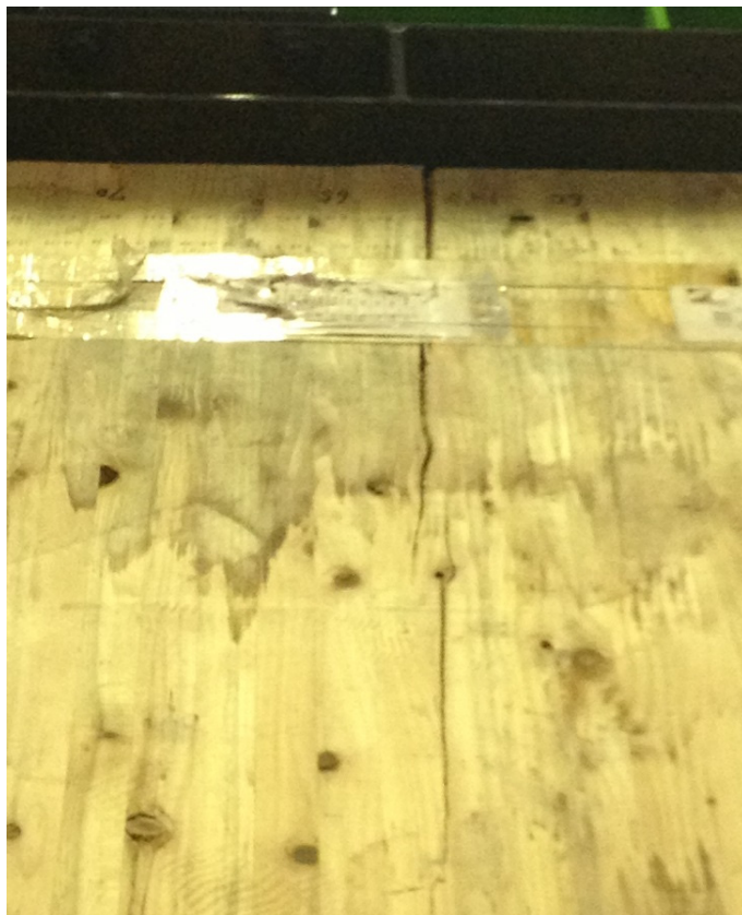
b) 木質パネル頂部のせん断破壊状況
