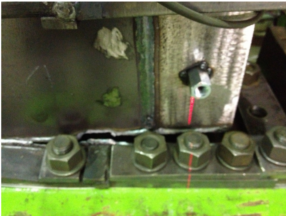
b) 柱脚部の破断状況
