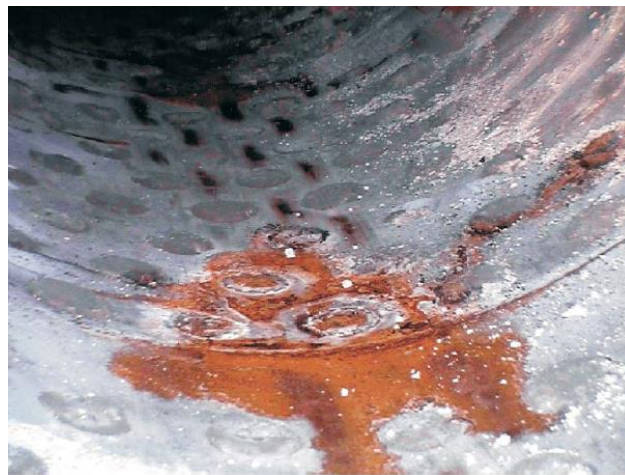
図 7-17 ライナ底部の腐食状況写真 14)
