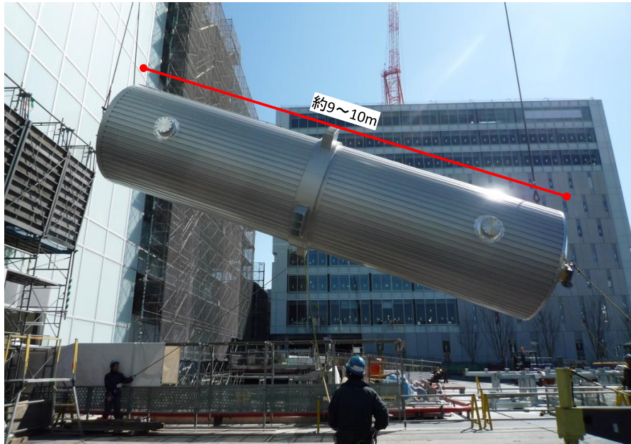
図 1.2.2 縦型氷蓄熱槽に用いるタンクー基の全景
